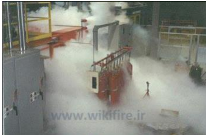
نمونه کاربرد سیستم اطفای حریق CO2 در صنعت
